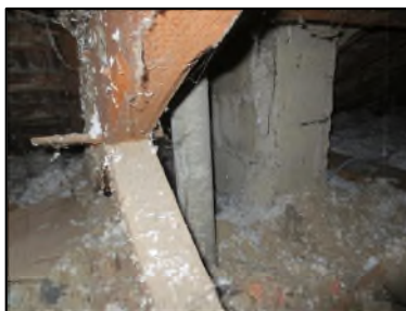
Photo N° 605 AMIANTE CIMENT -- Combles Conduits de fluide Ventilation haute (Fibres-ciment)
