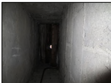
Photo N° 604 AMIANTE CIMENT -- Gaine technique 4 Gaines & coffres verticaux Ventilation haute (Fibres- ciment)
